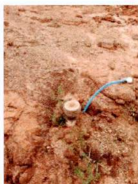
Pontos de espera da rede de esgoto estão recebendo areia para evitar acúmulo de água da chuva
