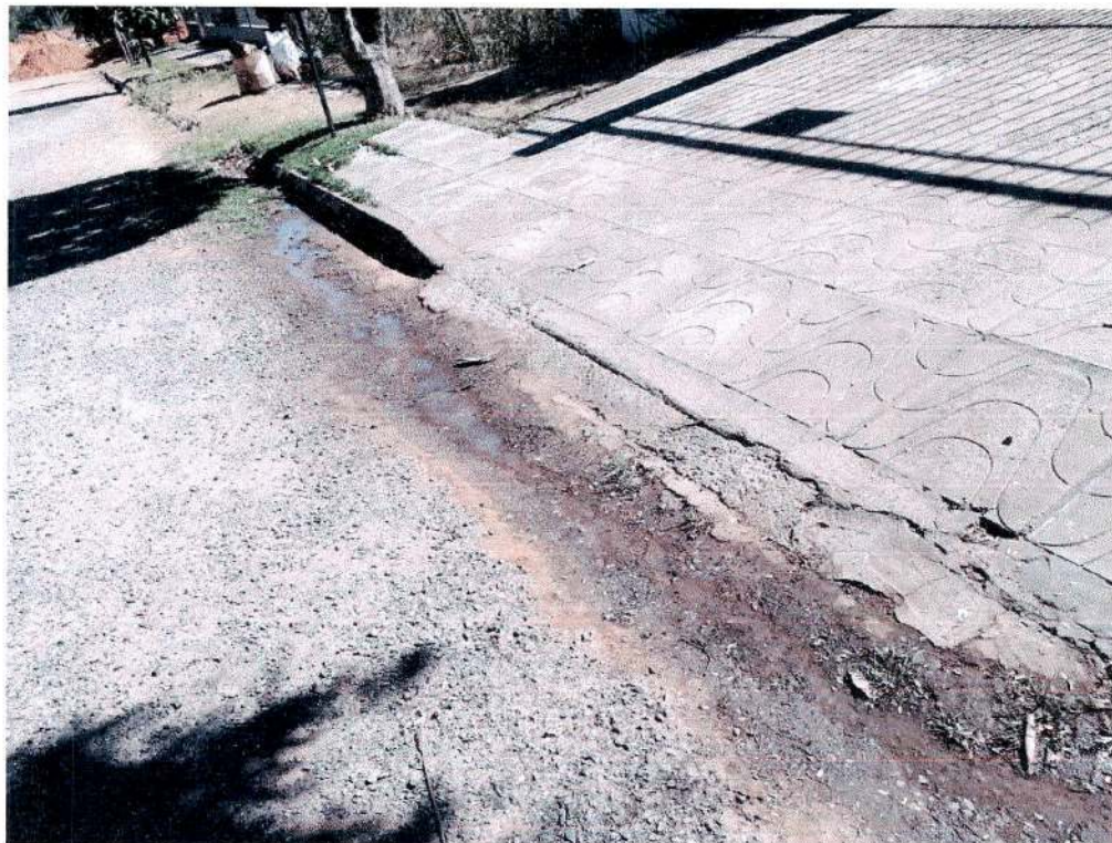
Foto 2: residência com lançamento de águas servidas na rua.
