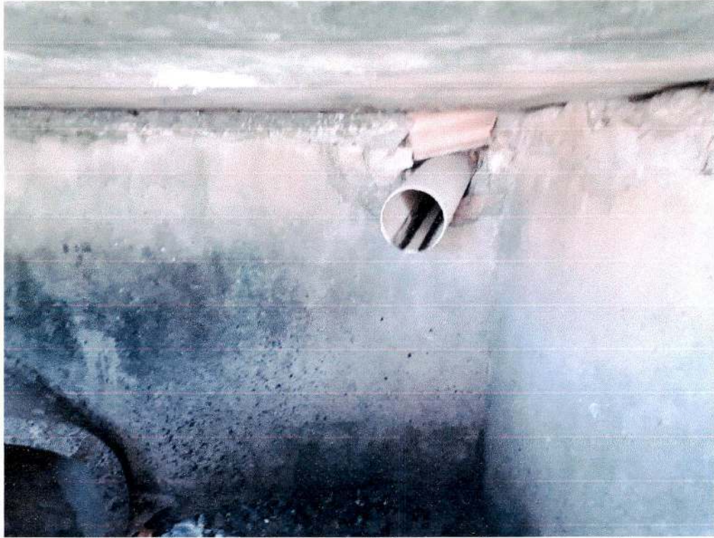
Foto 4: residência com lançamento de águas servidas na boca de lobo.
