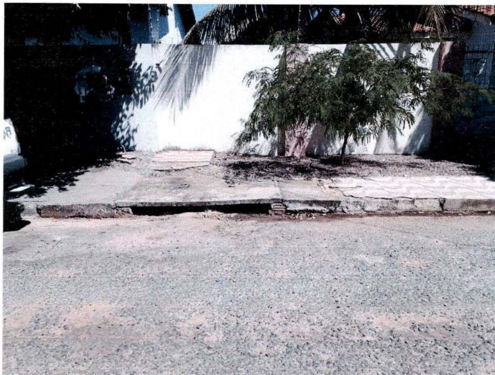
Foto 6: lançamento de águas servidas na boca de lobo.
