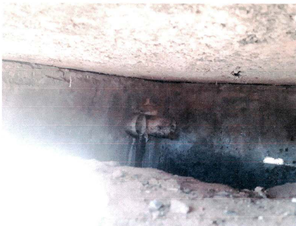
Foto 7: lançamento de águas servidas na boca de lobo.
