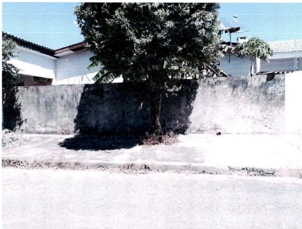
Foto 3: residência com lançamento de águas servidas na rua.
