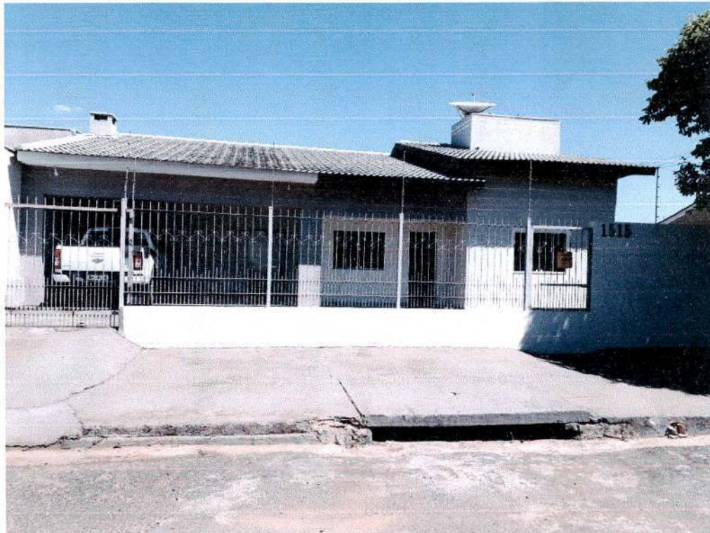
Foto 5: residência com lançamento de águas servidas na boca de lobo ao lado.
