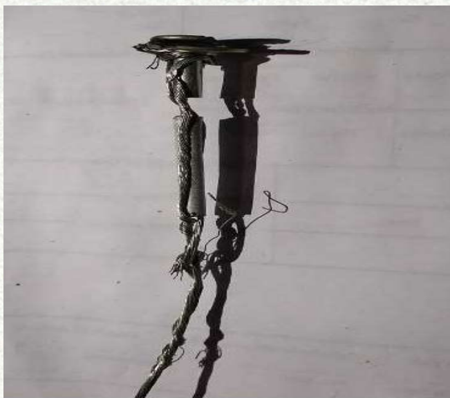
Figura 5 - Arame e cordoalha no lugar de elos fusíveis compatíveis.
