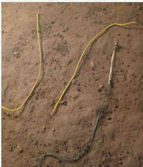
Figura 6 - Cabos inapropriados no lugar de elos fusíveis compatíveis
