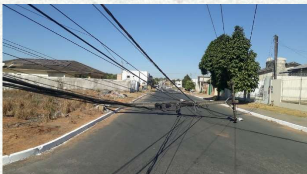
Figura 4 - Poste caído devido abalroamento por veículo.
