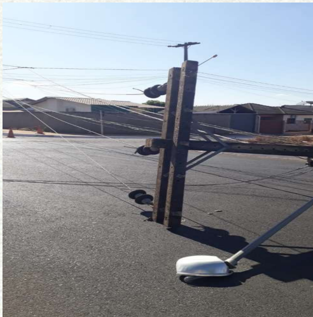
Figura 3 - Poste caído devido abalroamento por veículo em área urbana
