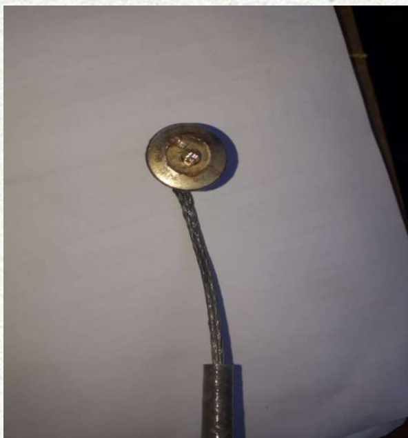
Figura 7 - Elo de 40k inserido por terceiros e inadequado para o local
